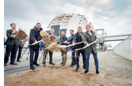
Im Rahmen einer feierlichen Zeremonie wurde heute der erste Spatenstich für die neue Landstromanlage am Norwegenkai in Kiel gesetzt.
